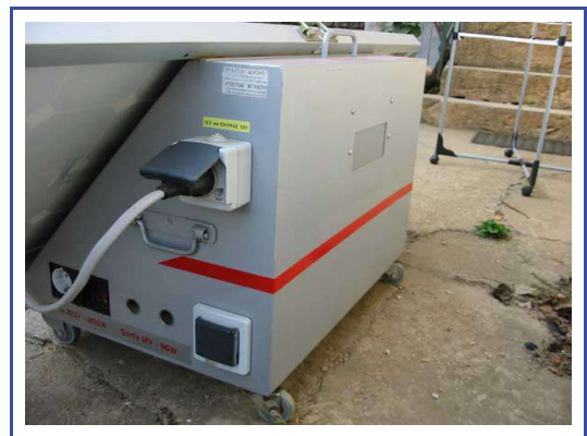
Vue latérale sur les branchements
